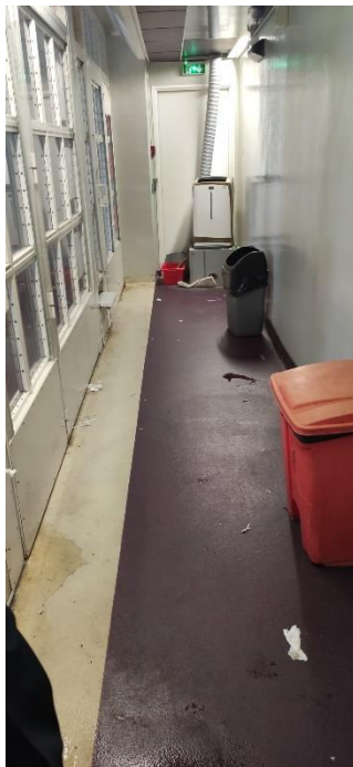
Climatisation installée dans le couloir des cellules collectives du commissariat de la Goutte d'Or
