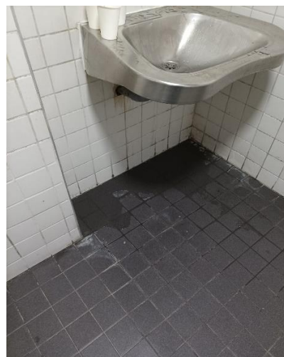
Fuites d'eau sous le lavabo en inox situé dans le local sanitaire des cellules collectives (2 décembre 2022)
