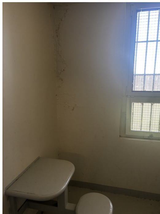
Cellule du QD — mobilier (table, tabouret) et infiltration constatée sur le mur
